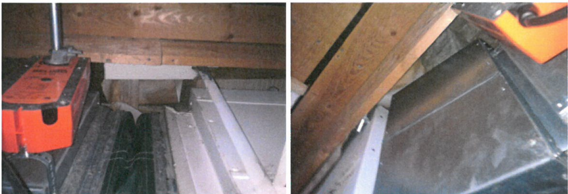
Kuva 2. IV-koneen läpiviennit ovat epätiivitä
