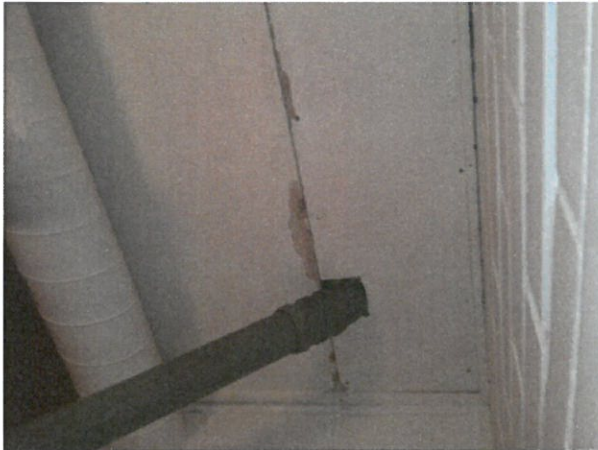
Kuva 1. Viemäroinnin läpivienti, josta tapahtui ilmavuotoa.
